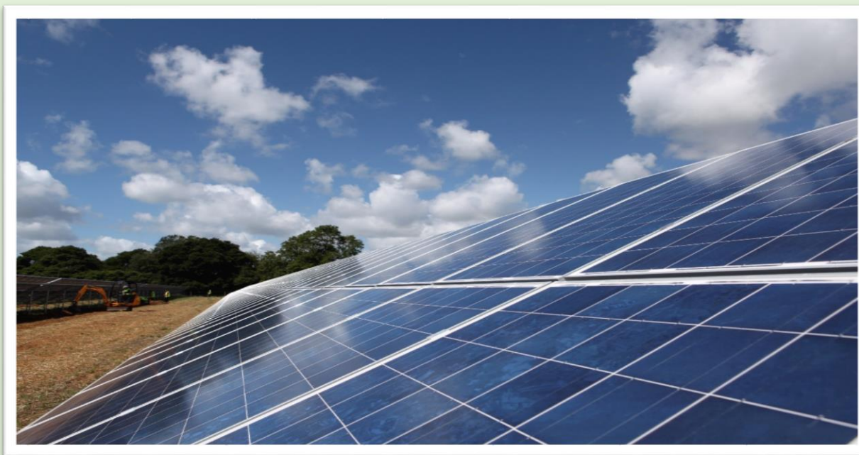
Figura Nr.37. – Pamje panelesh fotovoltaike, të cilat shfrytëzojnë energjinë e ardhur në Tokë nëpërmjet rrezatimit diellor, për të prodhuar energji elektrike.
