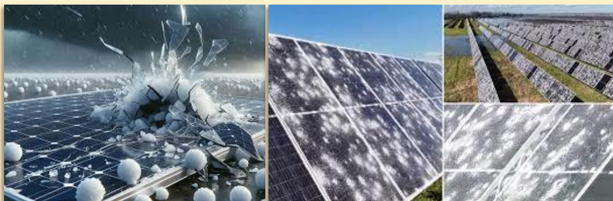
Figure Nr.38 – Pamje të disa sistemeve fotovoltaike të dëmtuara nga breshëri. View of some photovoltaic systems damaged by hail.
